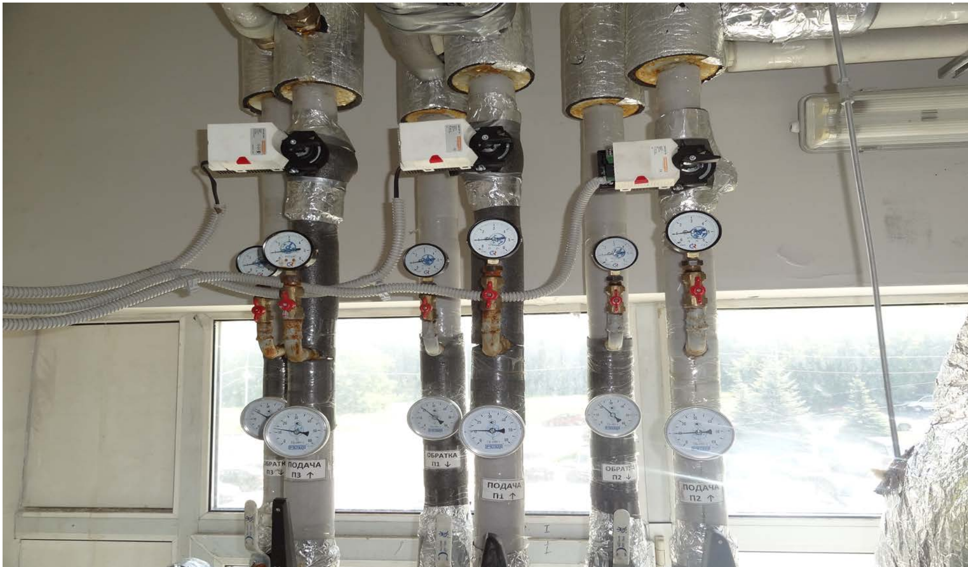
• Температура холодоносителя на распределительной гребенки у приточных установок.
